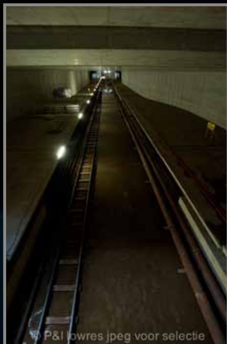
■ Bovengrondse aanvoer Op het tijdelijke werkspoor ten noorden van Station Zuid nadert een trein met kompels en materieel.
